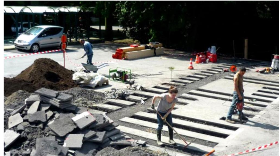
desealing-depaving e creazione di pavimentazioni drenanti con funzioni di impianto di nuove alberature
